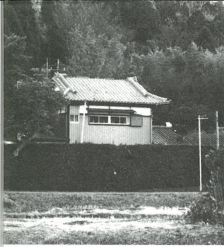
峰瓦が落ちた民家 篠本一区
