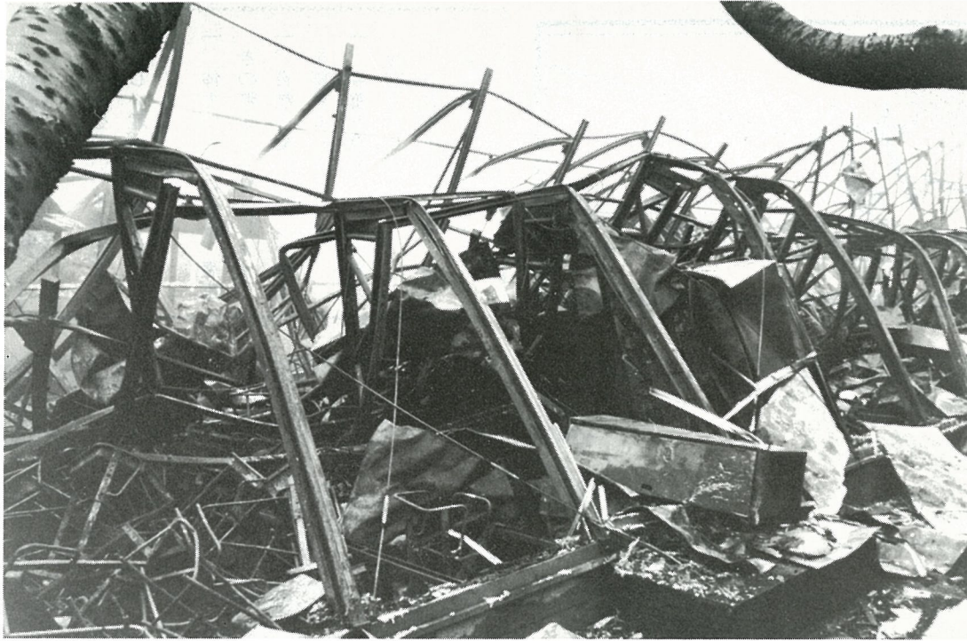
焼け落ちた仮設校舎
