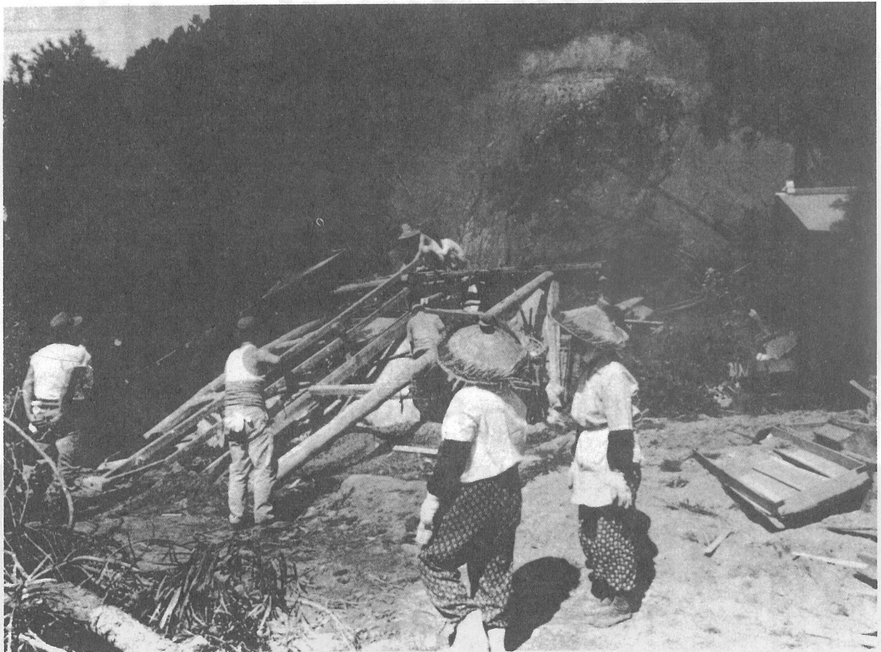
ガケくずれのためむざんに押しつぶされた住家の復旧に懸命の部落の人々
