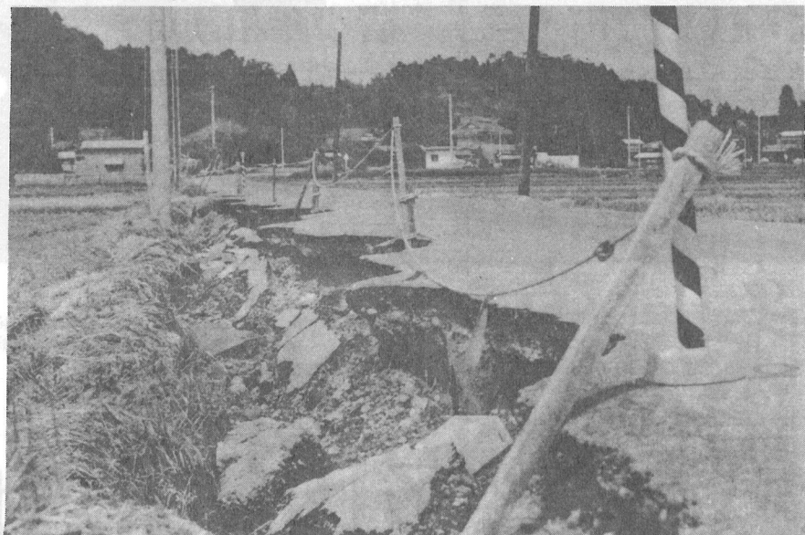
〔路肩がくずれた県道横芝停車場・吉田線〕
