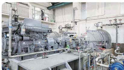
排水機場（更新後）
