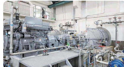
排水機場（更新後）
