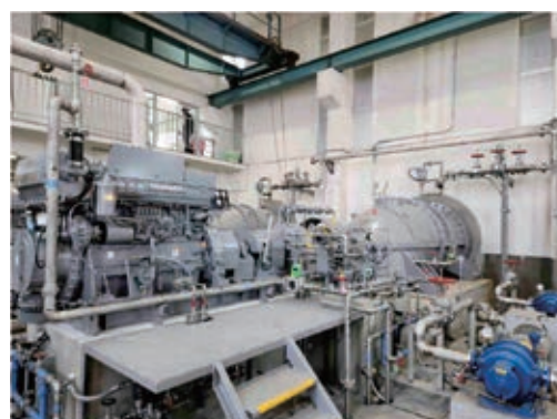
排水機場（更新後）
