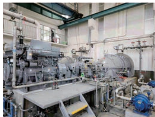
排水機場（更新後）
