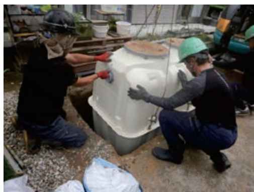
合併処理浄化槽
