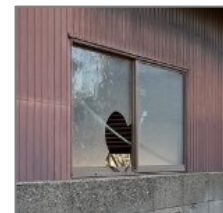
窓が割れた管理不全空家
