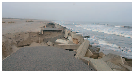
地震で破壊された尾垂浜の護岸
