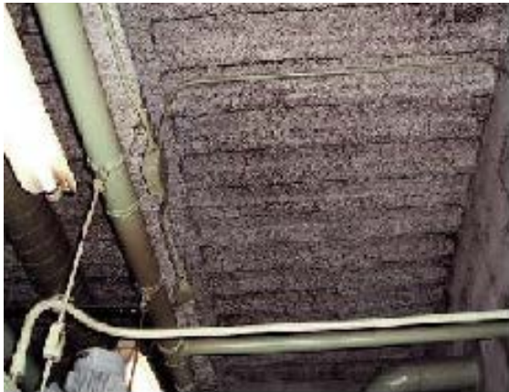
石綿含有吹付けロックウール
