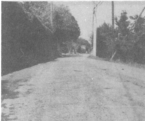
▲損傷がひどく早期修繕が望まれる町道 (鳥喰新田地先)
