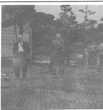
組立ても終り工事を待つプールの鉄筋 立っているのは町長と請負者
