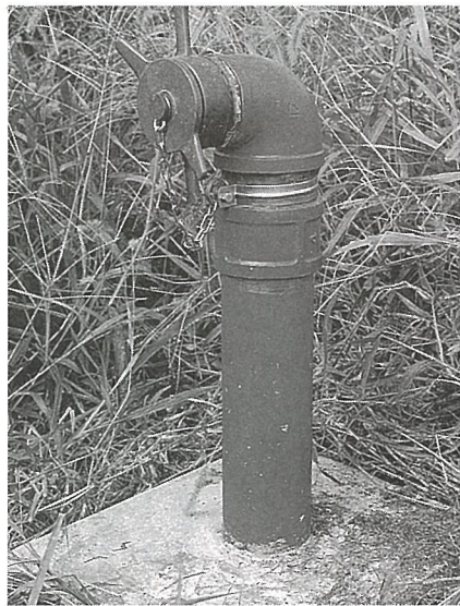
大規模災害時に生活用水を確保するため、光文化の森公園に設置した集水複合井戸
